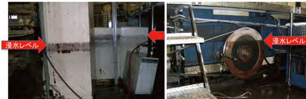
写真13 浸水した印刷工場
