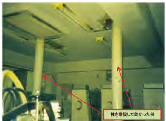
写真11 柱を増設して助かった例
