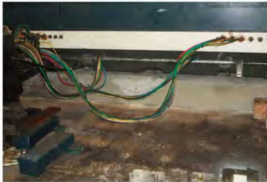
写真3 枚葉機の基礎部崩壊
