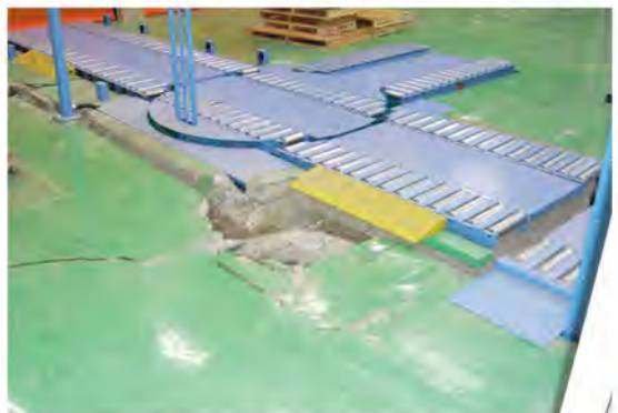
写真2 印刷工場コロコン部床陥没
